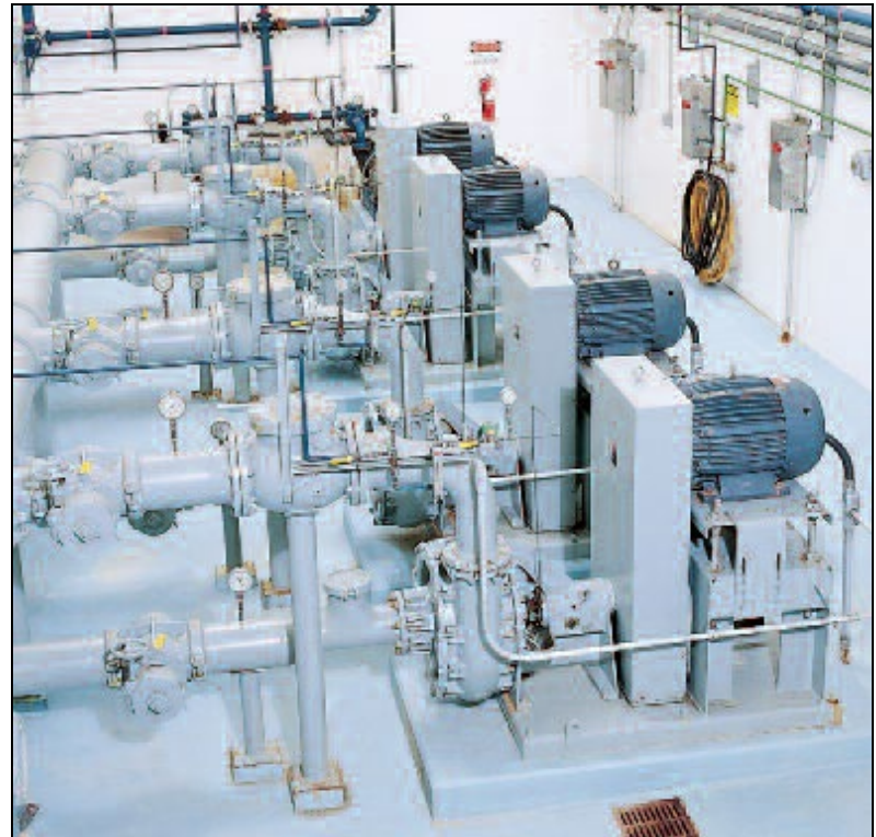
Discharge Pumps, Bellwood Ave CSO
